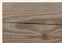
Spannungsrisse durch die Holz-trocknung
